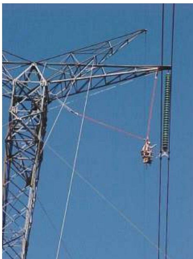
Fig. 5 – Isolador em linha de transporte de energia
